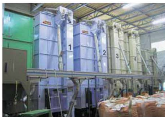
乾燥機やもみすり機(ヤンマーACH60)などがズラリと並ぶミニライスセンター内部
