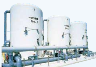
海水ろ過施設
