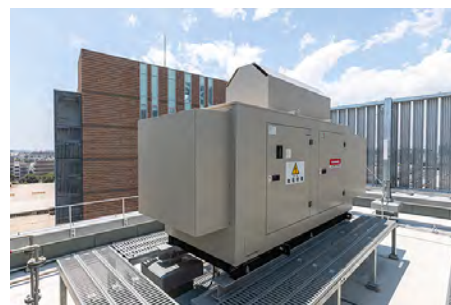
実証運用に使用した非常用発電機
