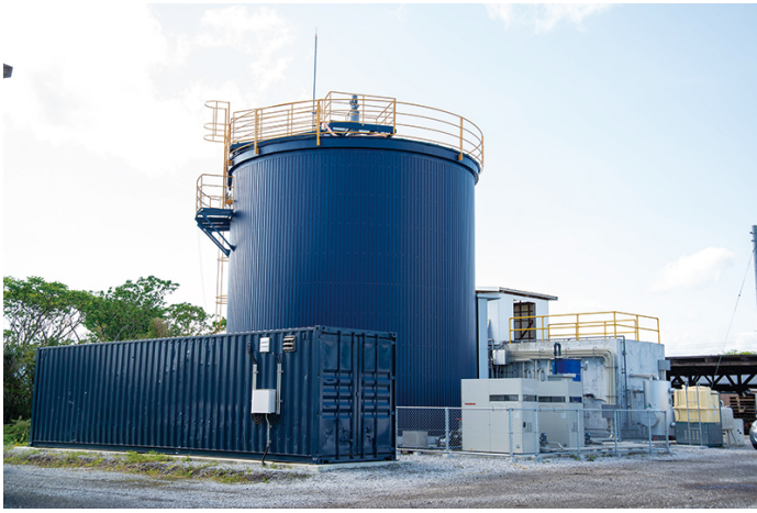
バイオガス発電プラント
