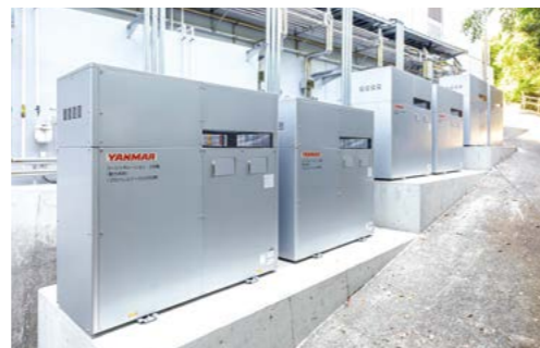
ホテルアンピア松風閣に設置したコージェネレーションシステム
