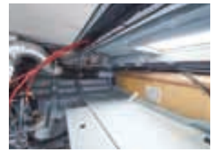
補機設置スペース
