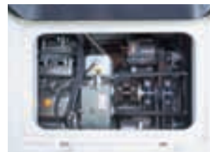
エンジンルーム出入口ハッチ【キャビン】
