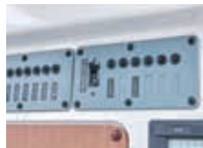
ブレーカーパネル
