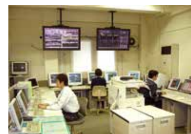
遠隔監視センター
