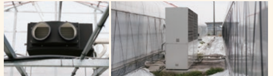
室内機は、機体の影を減らし、噴き出す風の影響を抑えるために12ヶ所に分散設置（写真左）。室外機は効率を考えた2棟の間に設置している（写真右）。
