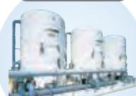
海水ろ過施設
