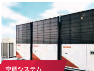
空調システム
