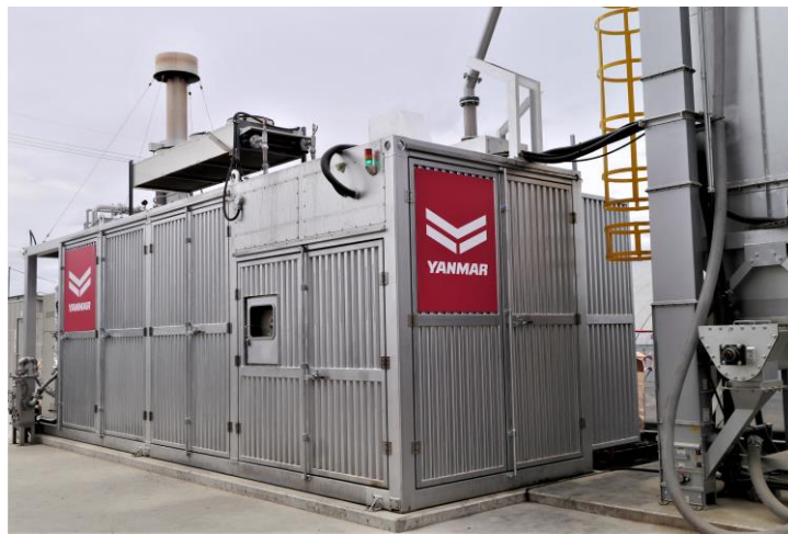
<もみ殻ガス化発電システム>
