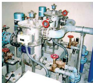
SFS80×2基並列：自動逆洗システム
