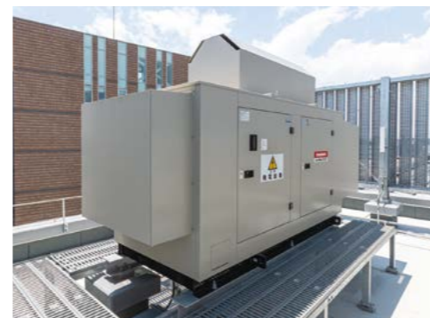
実証運用に使用した非常用発電機
