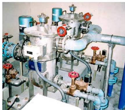
SFS80×2基並列：自動逆洗システム
