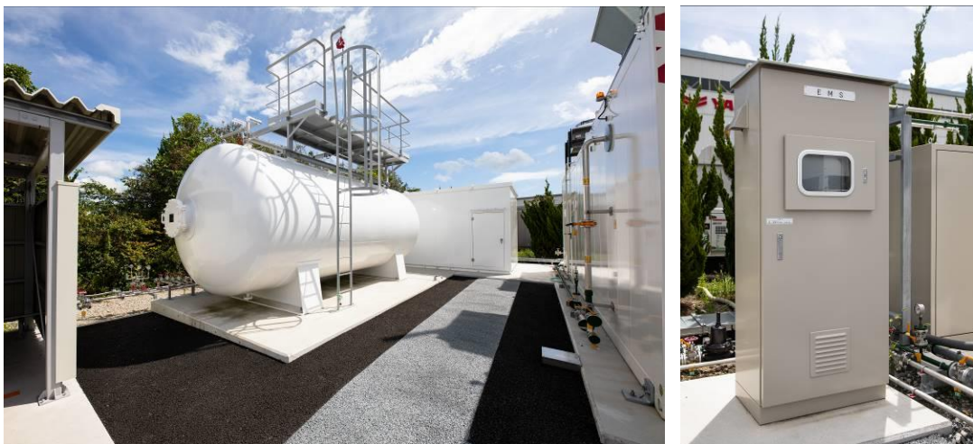
<左:水素タンク・水素製造装置、右:エネルギーマネジメントシステム>
