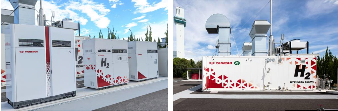
<左:左から水素燃料電池発電システム、水素混焼 CHP、都市ガス仕様 CHP、右:2G 社製水素燃料エンジン CHP>
