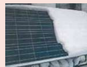
太陽光パネル
