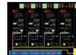
制御盤モニター
