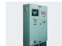
システム制御盤
