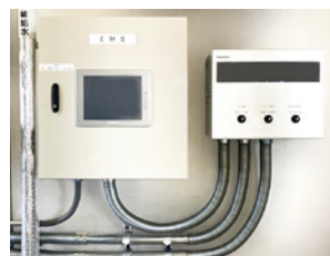
▲廃熱の最大利用を制御 (CGSコントローラー) とシステム全体の見える化 (Y-EMS)
